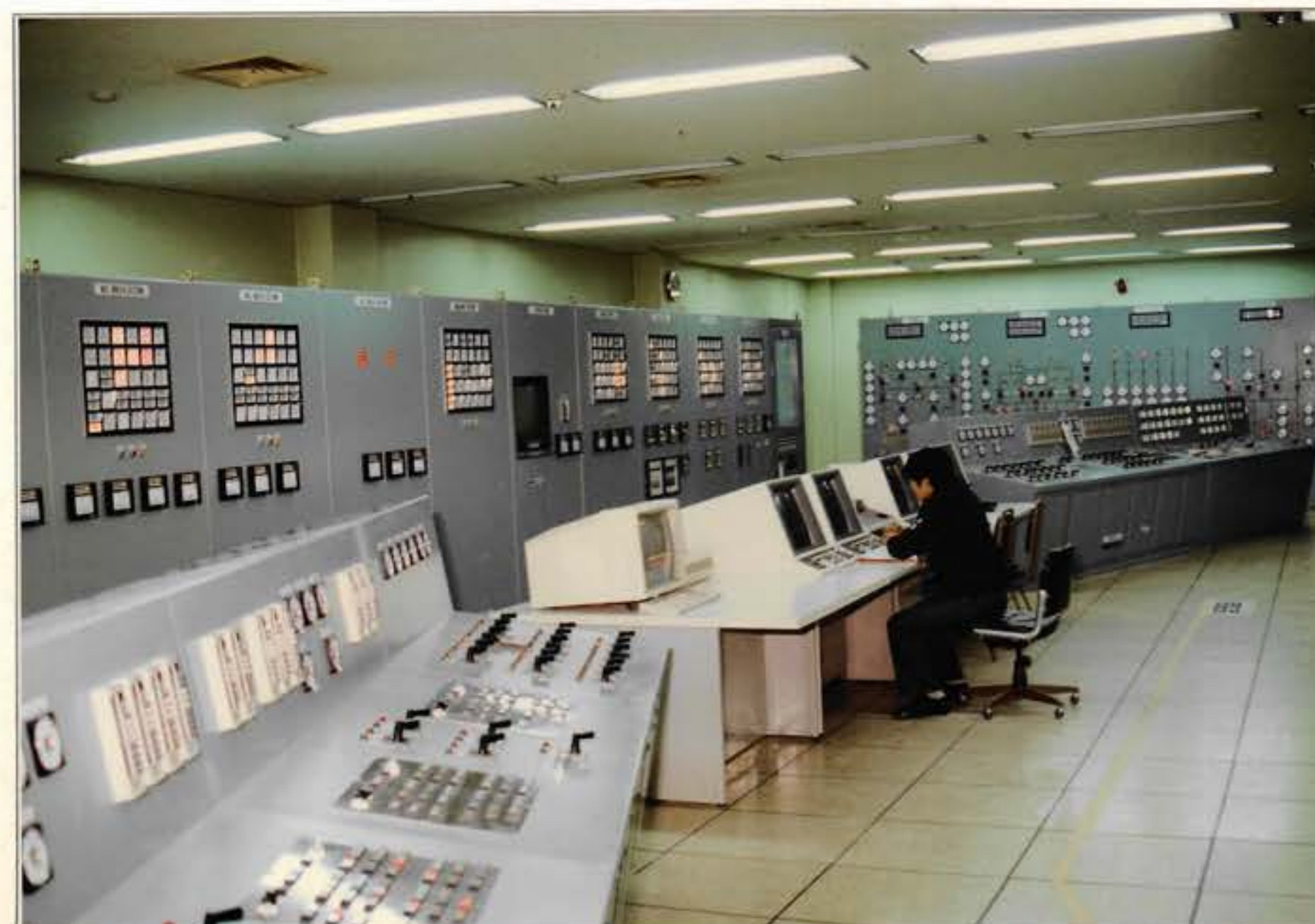
中央制御設備
