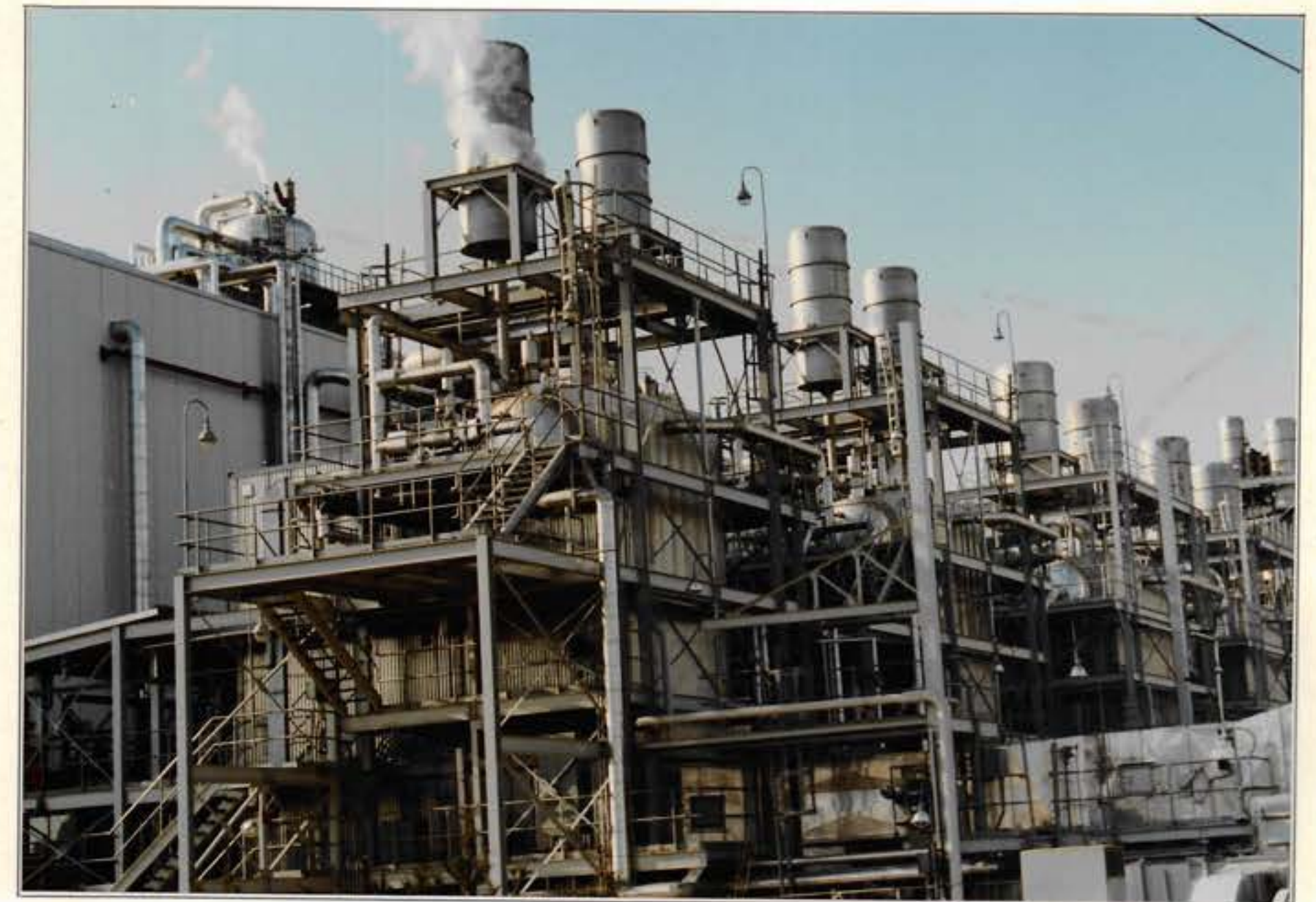
暖房用보일러施設
